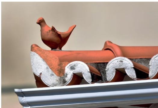
Muratura della prima fila di coppi: scelta deleteria per rondoni e passeri.
